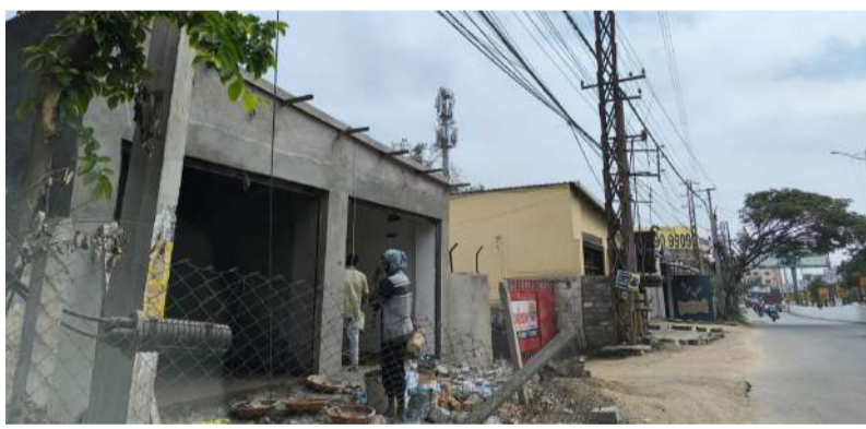
నిజాంపేటలో నిర్మిస్తున్న అక్రమ నిర్మాణం
